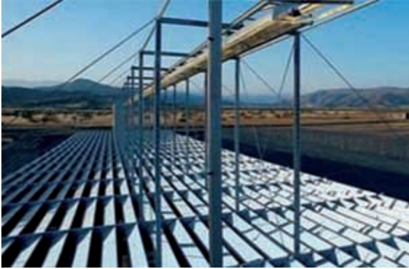
Figura 4.11.9. Instalación de colectores lineales de Fresnel en la Plataforma Solar de Almería
