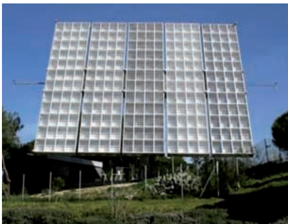
Figura 4.9.9. Instalación solar fotovoltaica de concentración
